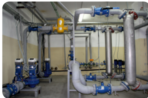
Индивидуальный тепловой пункт
