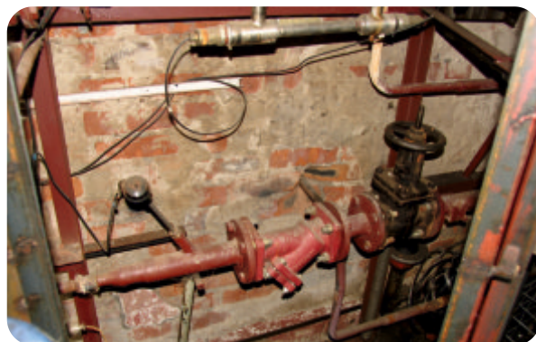
Нереконструированные тепловые пункты
