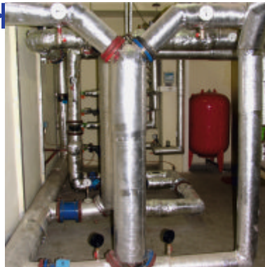
Индивидуальный тепловой пункт
