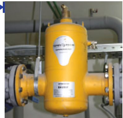
Очистка и деаэрация воды
