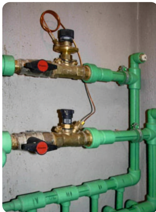
Автоматические балансировочные клапаны на поэтажной разводке
