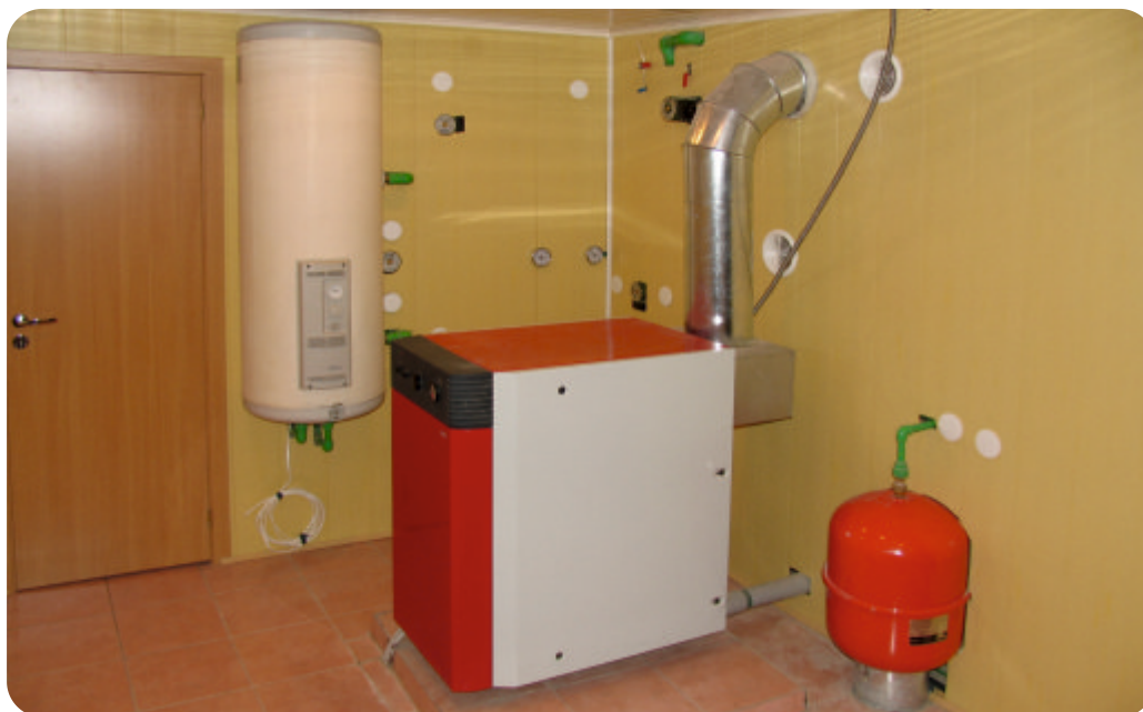
Центральный узел инженерных коммуникаций частного дома
