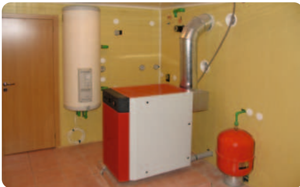
Центральный узел инженерных коммуникаций частного дома
