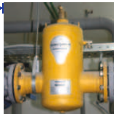
Очистка и деаэрация воды
