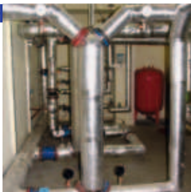
Индивидуальный тепловой пункт
