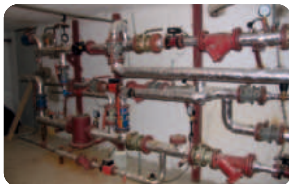
Тепловые пункты, прошедшие реконструкцию
