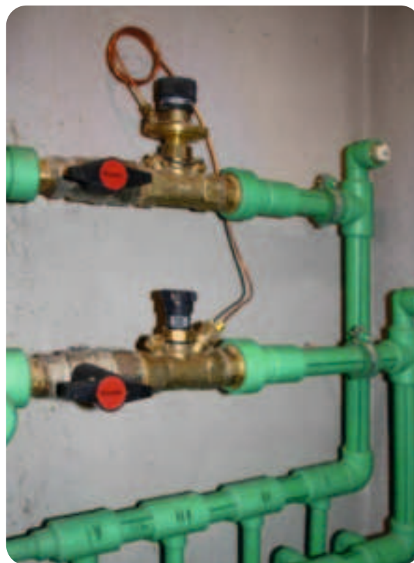
Автоматические балансировочные клапаны на поэтажной разводке
