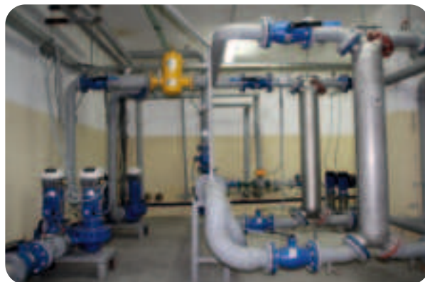
Индивидуальный тепловой пункт
